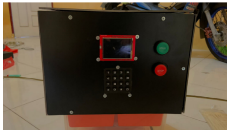
Gambar 2. Panel Box Tampak Depan
